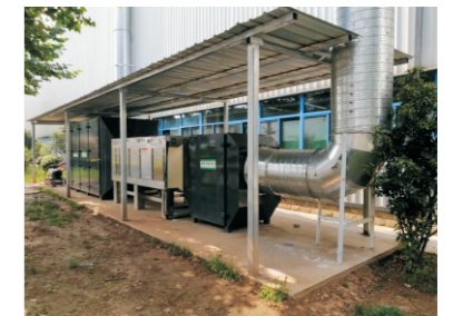
喷漆废气处理系统
